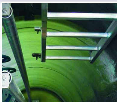
Встроенная лестница для техобслуживания
